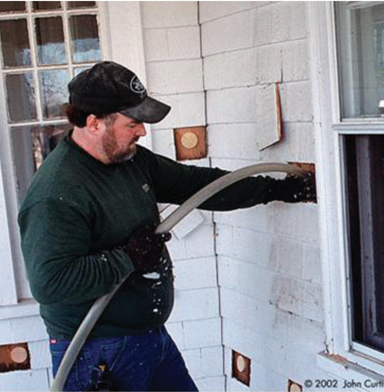
Exterior wall fill tube.
